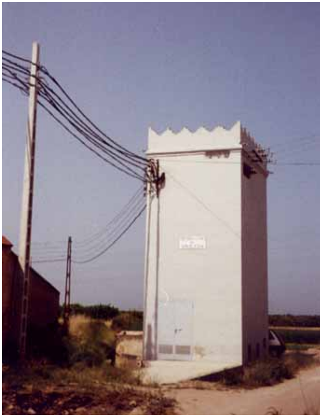
Caseta transformadora del Camí de Foios
